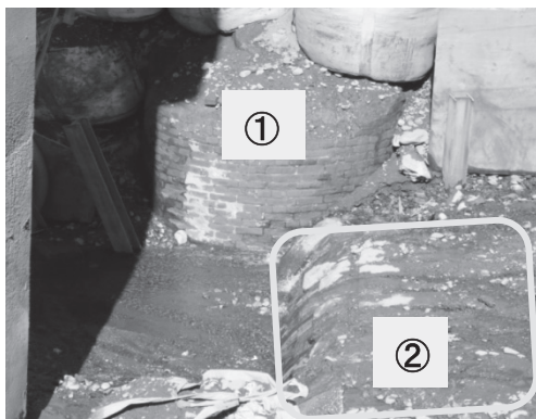
写真17 旧橋脚P-9 基礎部①と転倒した橋脚上部② (カラー写真別紙)
