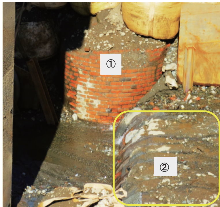
写真17 旧橋脚 P-9 基礎部①と転倒した橋脚上部②
