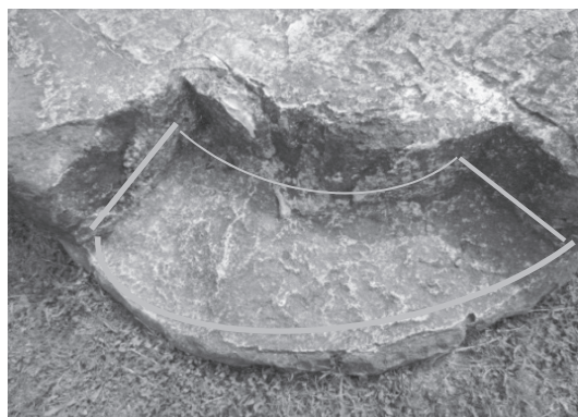
写真 14 P-22 石材が剥落している
